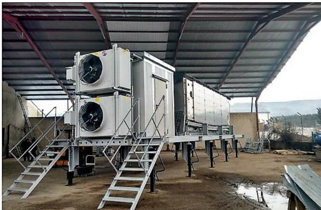
La planta de torrefacción ya está instalada en una nave del polígono industrial de Duruelo. Ahora se están colocando los ordenadores y en breve comenzarán las pruebas.
